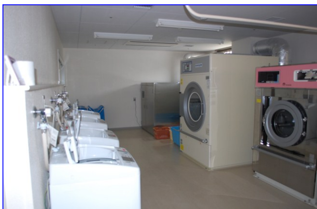
【ランドリー室】
